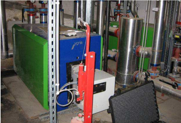
Installation de chauffage de l'administration.
