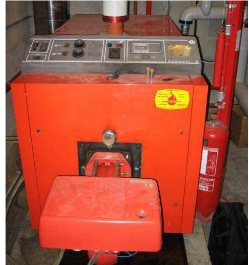
Chaudière du hall omnisports
